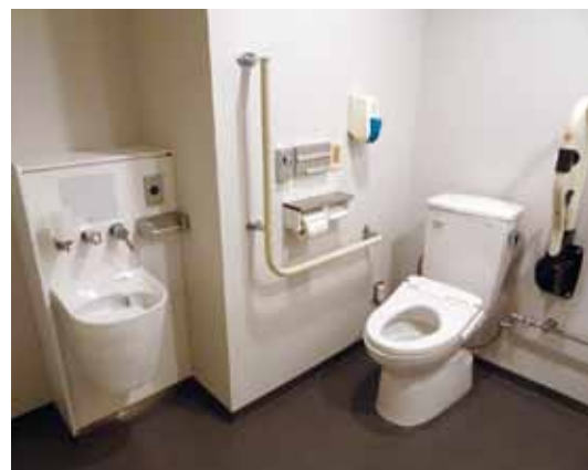
▲ 1階多目的トイレにはオストメイト対応設備を設置
